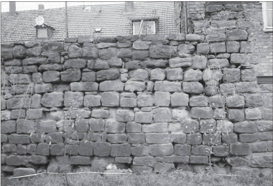
Abb. 1: Mauer an der Windischen Gasse von der Robert-Koch-Straße gesehen. Starke Auswaschungen der Fugen; Steinzerfall in der Sockelzone
