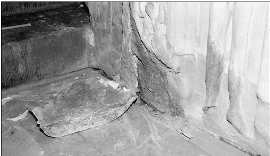
Abb. 3: Detailansicht der abgenommenen Zementergänzung an der östlichen Fruchtgirlande
