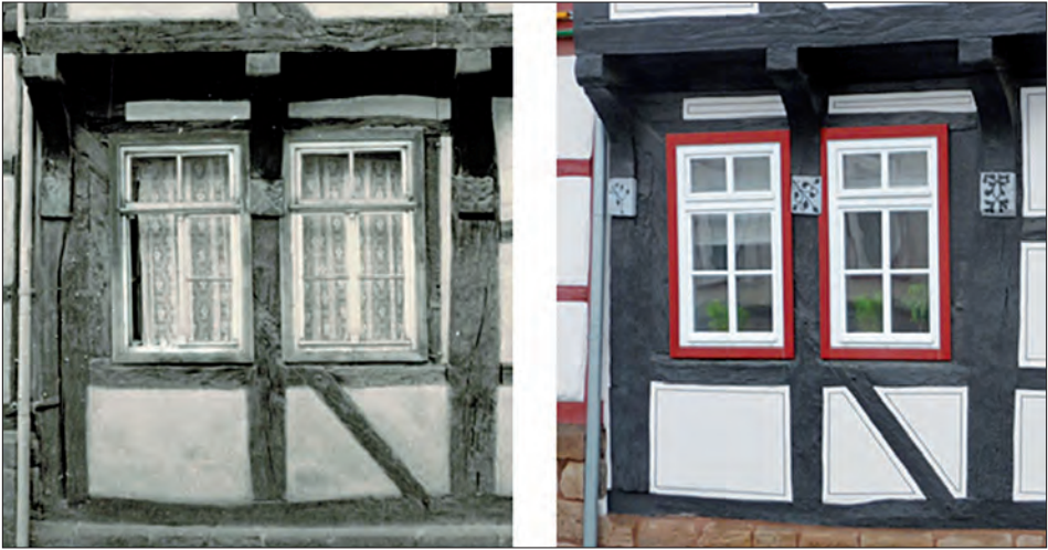
Abb. 12: Links: Detailausschnitt der Endfelder der Ostfassade im 1. Stockwerk zwischen Ständer 1 und 3. Zustand um 1970; rechts: gleicher Detailausschnitt mit dem Zustand von 2012. Fotos: K. A. Heidenblut.
